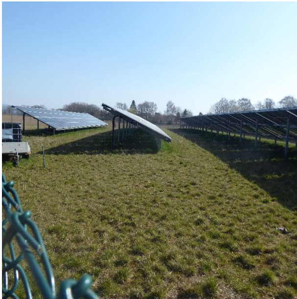
Abbildung 29: Freiflächenanlage Lemgo (744kW)
