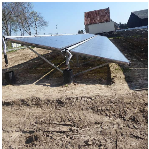
Abbildung 22: Solarthermiefeld an der Kläranlage
